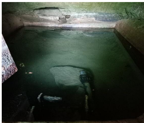
Depósito del Haya lleno
